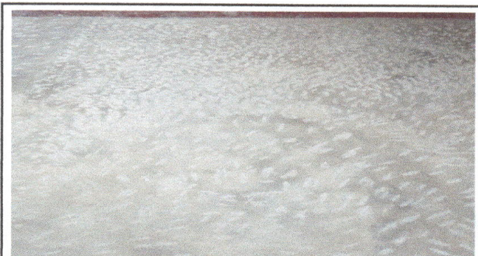
Foto 4: Se observa la picada del piso
